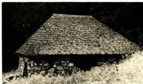
Chatka Rainera z dużym ubytkiem w kamiennych ścianach — stan z sierpnia 1979 r.
